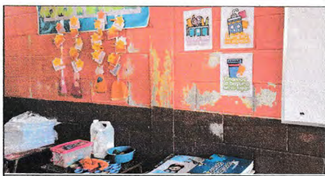
Foto 6: La pintura en las paredes exteriores e inferiores se encuentran en mal estado.
