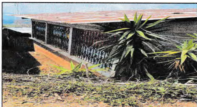
Foto 3: La Escuela cuenta con balcones, pero no cuenta con Ventanas, en horario de clases los niños sufren del sol, del viento y de la lluvia. (Parte de atrás del salón)
