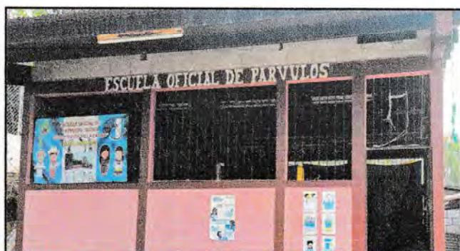
Foto 4: La Escuela cuenta con balcones, pero no cuenta con Ventanas, (Parte de enfrente del salón)
