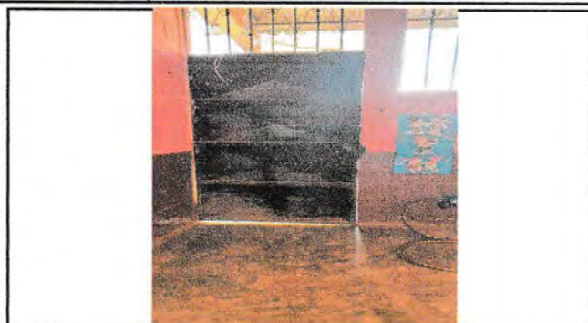
Foto 2: La puerta principal y única del salón de clases se encuentra en deteriorada, se encuentra picada por óxido.
